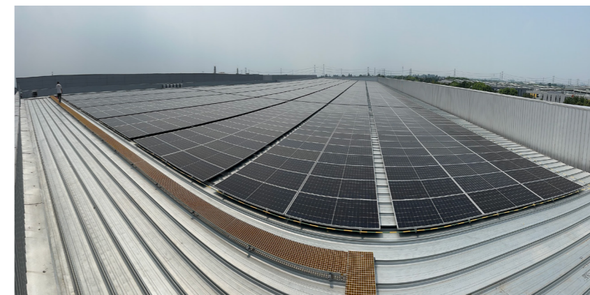
2MWH 光伏屋顶
